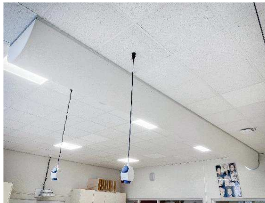
Opgeleverd lokaal Hofstraat met lucht installatie
